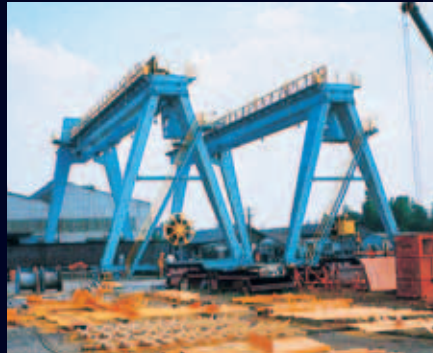
橋形クレーン
