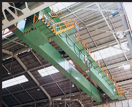
天井クレーン
